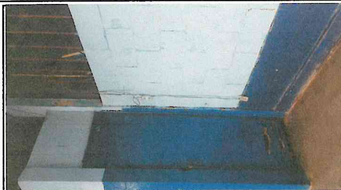
1. puerta en mal estado
