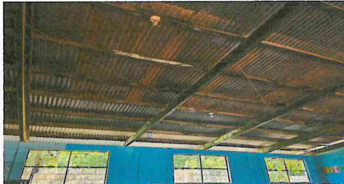
6. laminas agujeradas y oxidadas
