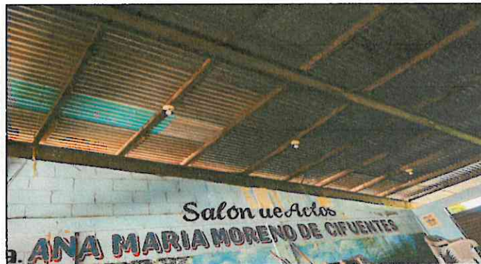
4. servicio electrico desgastado e inservible
