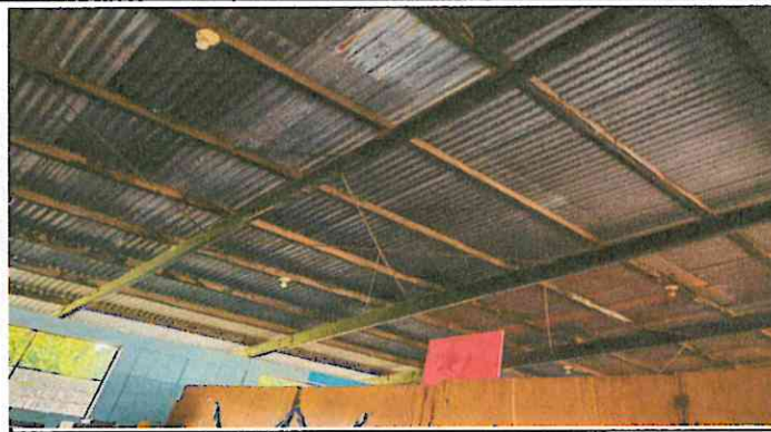
2. cantel en mal estado, apolillado y empanzado de agua
